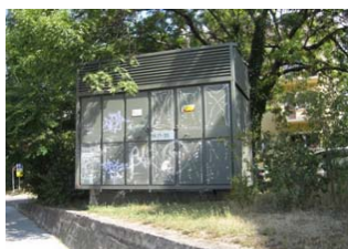
1 ábra. Korszerűtlen, lemezházas transzformátorállomás Veszprém 6
